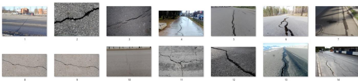
Рис. 8. Набор изображений с трещинами
