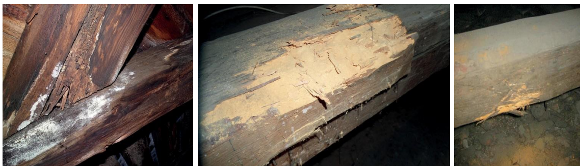
Рис. 1. Повреждения деревянных элементов
