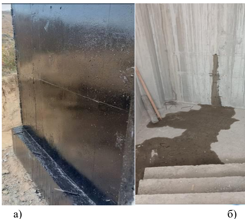
Рис. 3. Вид подземной монолитной железобетонной конструкции: а – гидроизоляция битумной мастикой, б – под воздействием воды
